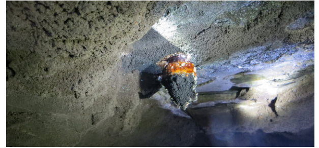
Eisensinter an der Stollenwand
